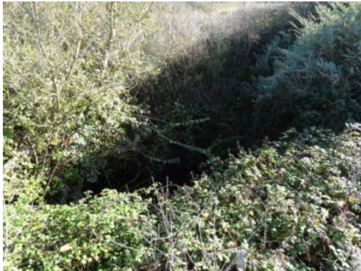
Ruisseau de la Normandelière (partie médiane dégradée, située sous emprise)
